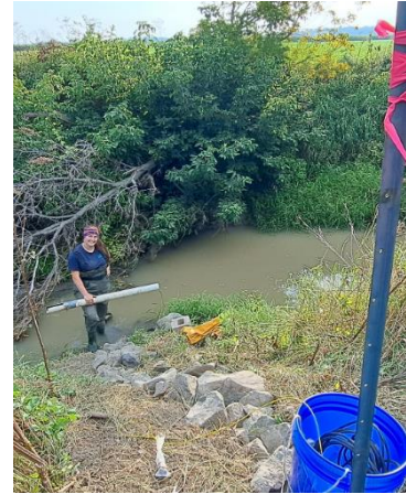
Figure 1: Installation de la station de suivis paramétriques de l'eau - Septembre 2023
